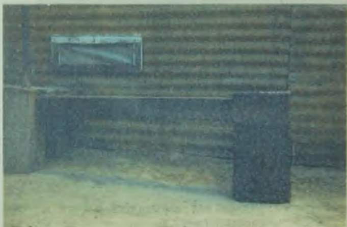
Рисунок 25 – Металлическая труба прямоугольной формы, внутри ее тепловая труба – дымоход
