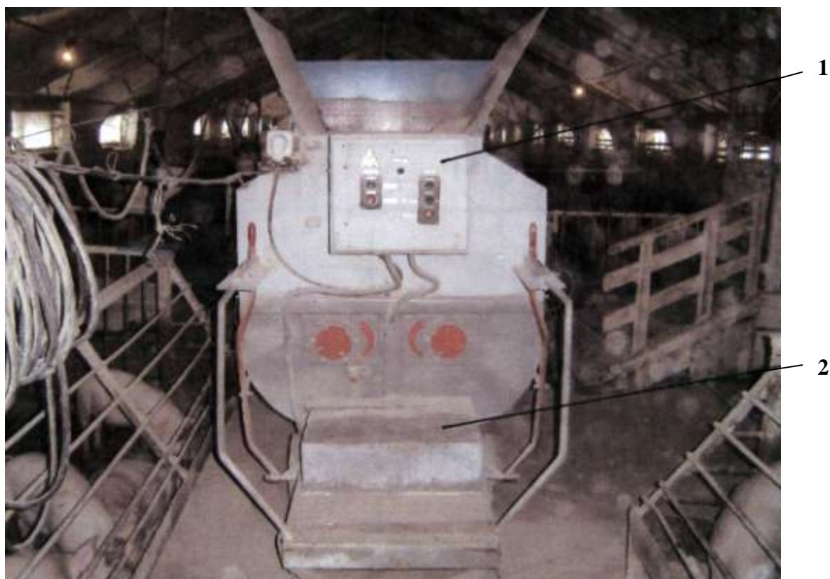
Рис. 4.6.13. Общий вид раздатчика-смесителя со стороны шкафа управления
